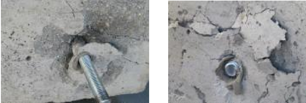
앵커볼트가 빠지거나 균열/손상이 발생한 상태
